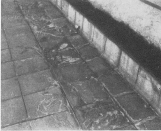
Abb. 2. Biologische Angriffe und Frostschäden
